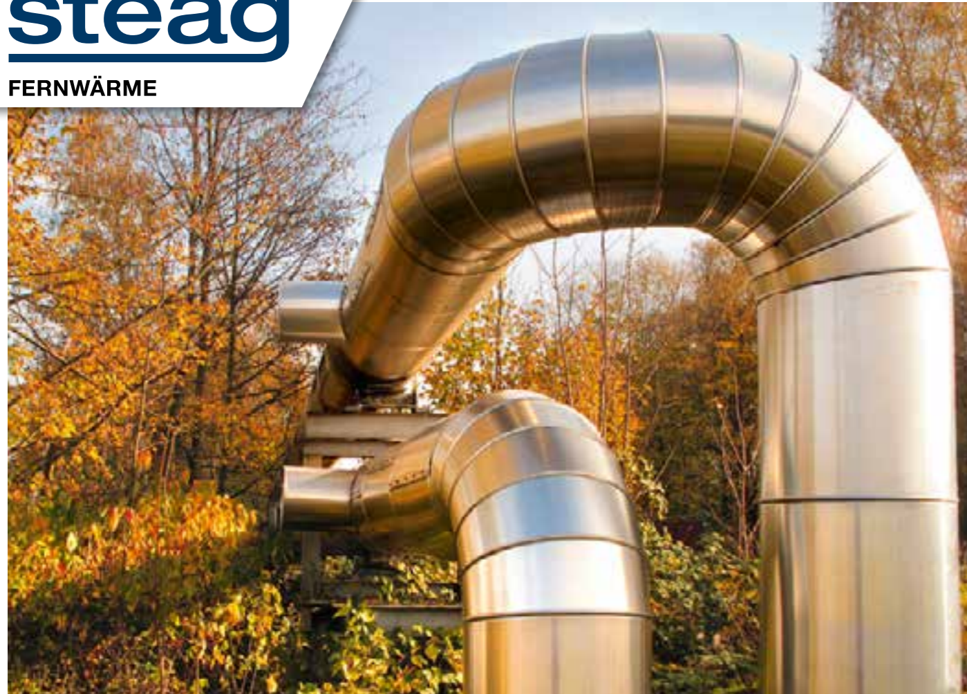
Über ein geschlossenes Leitungsnetz gelangt das heiße Wasser zum Kunden und wird dort zur Raumbeheizung oder Warmwasserbereitung zur Verfügung gestellt.
